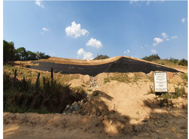
Foto 6: BF 7 Margem direita 31/08/2020
